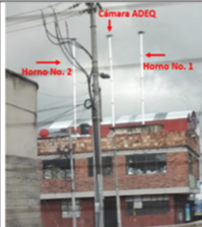
Fotografía 6. Ductos hornos de secado y cámara de presecado ADEQ
